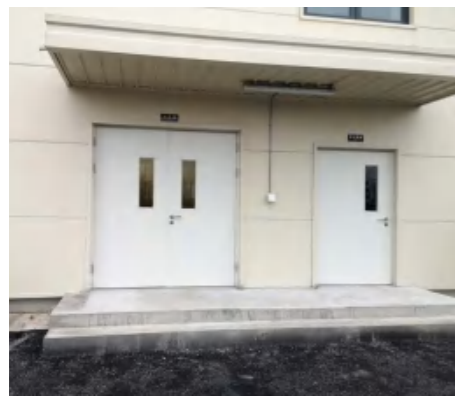
Steel fire door
